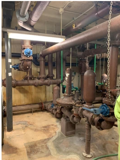
ODS Sludge Transfer Pump
